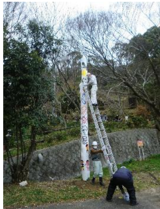
設置作業で欠損した塗装の修正
